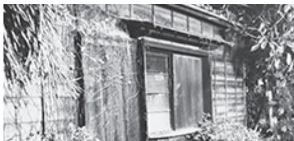
▲老朽化した空き家
