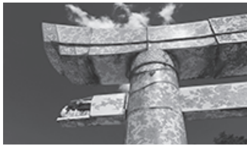
▲損傷著しい磁器製鳥居
