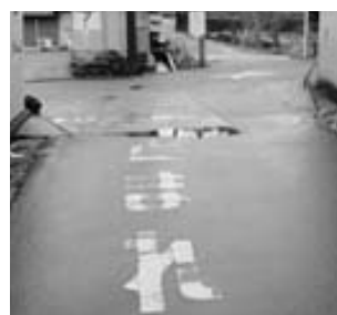
▲消えかかっている一旦停止線と路面標示
