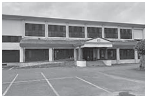
▲雨漏りのため改修予定の西有田中学校体育館
