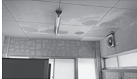
▲雨漏りしている曲川小学校トイレの天井
