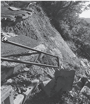
▲崩落した李参平公碑参道
