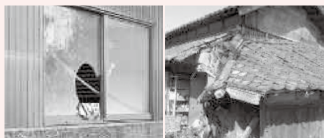
▲放置された空家（国土交通省資料より）
