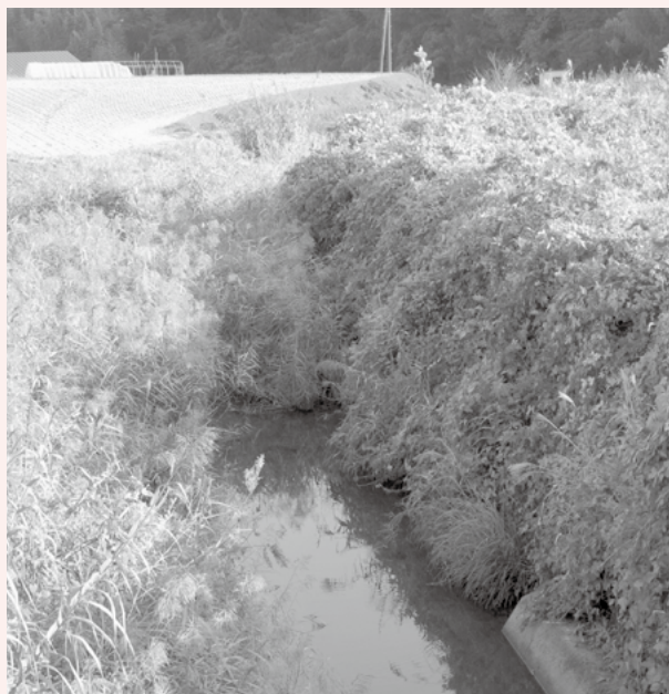
▲土砂が堆積して水路が狭く、葦が生い茂る唐船川
