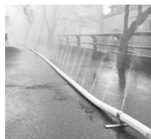
▲延焼防止水幕防御システム
