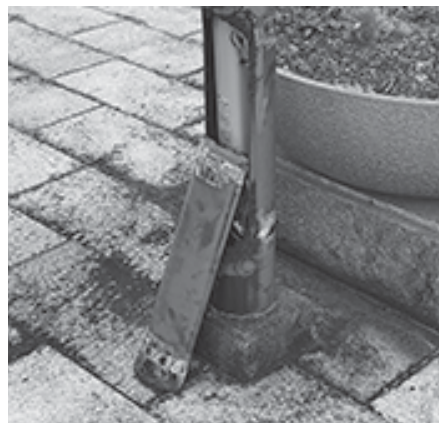
▲腐食した外灯
