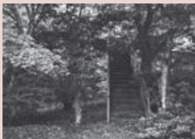
▲有田ダム展望台の老朽化した橋梁
