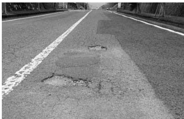
▲陥没のある町道
