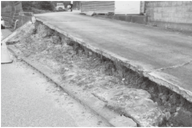
▲被害を受けた道路
