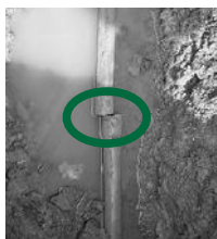
▲破損した水道管
