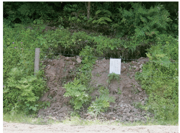
平成26年度 原明窯跡被害状況
