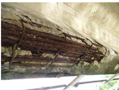
【コンクリートが広範囲で剥落した事例】
