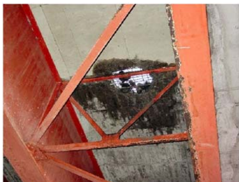
【床版が抜け落ちた事例】
