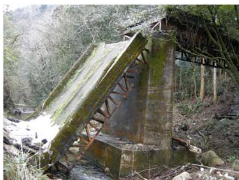
【適切な維持管理が行われず落橋した事例】
